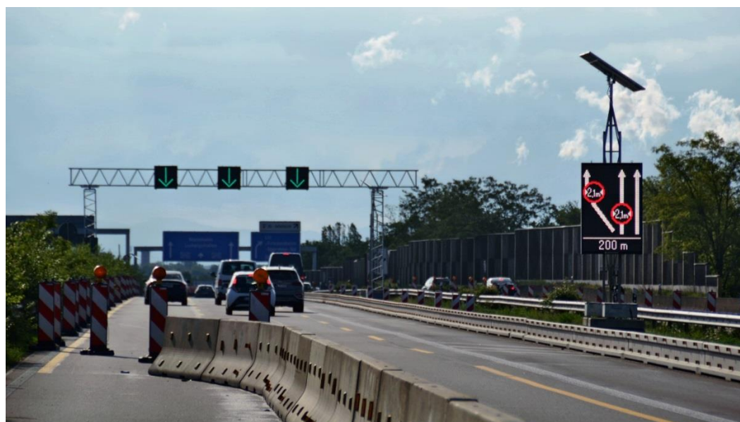
Photo 1+2: PMV et portique de signalisation des voies
