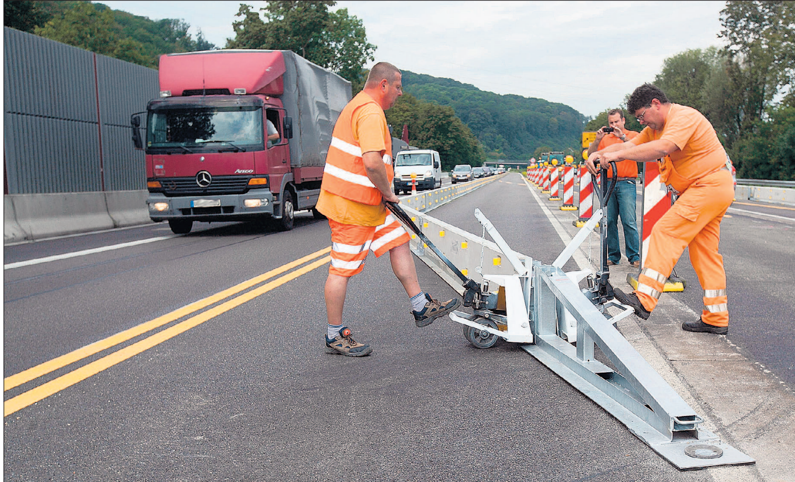
Weichenstellung auf der B 10: Jens und Olaf Giessler verschieben eine Betonwand, die den Verkehr durch den Baustellenbereich leitet.
